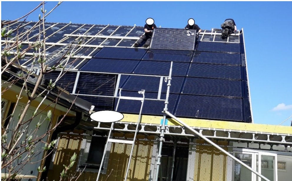
Figur 30 Bild från installationstillfället där man ser hur modulerna installeras direkt på en nylagd takläkt
