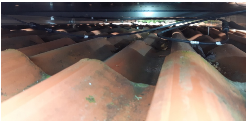
Figur 28 Felaktig och säkerhetsmässigt riskabel dragning av likspänningskablar under panelerna.
